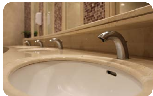
洗手台水龍頭使用紅外線感應設備調節出水量
